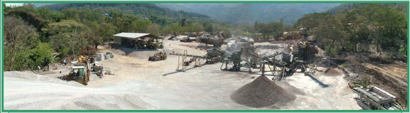
Foto 15: Planta de trituración del proyecto Santa Ana Huista-Jacaltenango. Nótese por un lado el acomodo del suelo orgánico para su posterior uso y por otro las áreas de trabajo bien definidas que permiten una mejor locomoción dentro del campamento de trituración.
