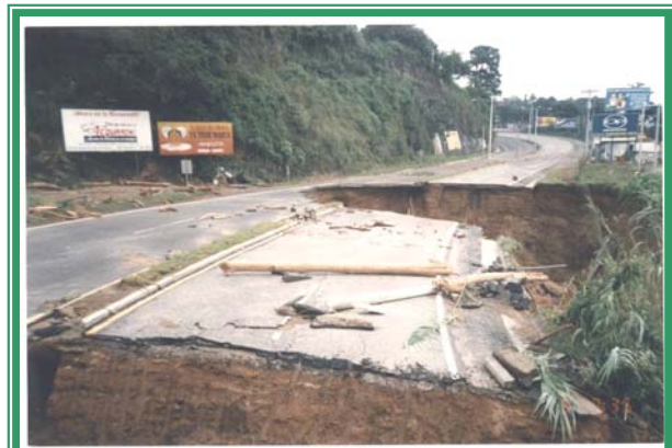
Foto 5: Aspecto de la carretera luego del paso del Huracán Mitch.
