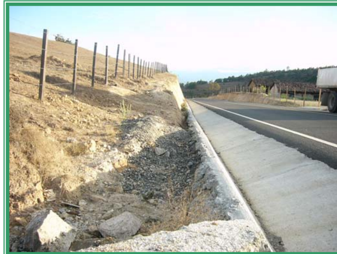
Foto 27: Descalce de cuneta
