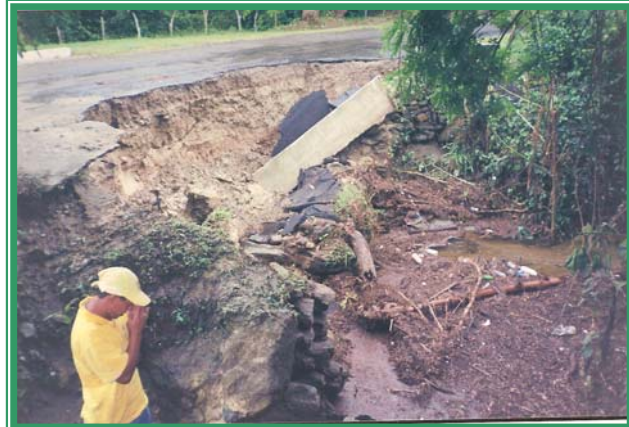
Foto 4: Proyecto RN5 San Miguel Chicaj – Salamá. Un mantenimiento a destiempo hizo fallar la cuneta y posteriormente se perdió media sección de la carretera.
