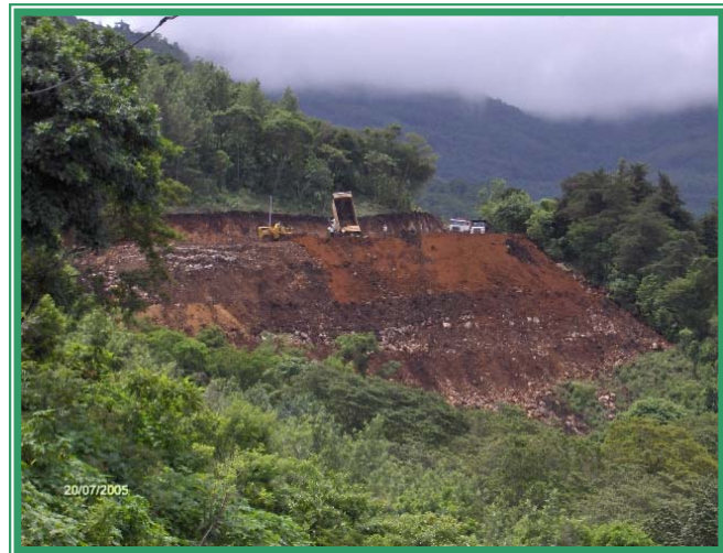
Foto 19: Pavimentación de la RD Huehue. 13. Tramo San Antonio Huista - Jacaltenango. Esta es otra vista del botadero de la foto 18 que ilustra como se contuvo el material luego de construir la borda con lo que se preservó el sotobosque al pie del botadero de material de desperdicio.
