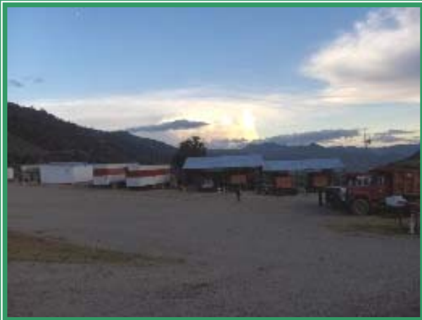
Foto 13: Proyecto de pavimentación RN18 Mataquescuintla – Jalapa. El campamento luce ordenado y organizado.
