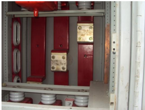
Figura 4. Barras de subestación 13.2kV en la planta Palmas II.
