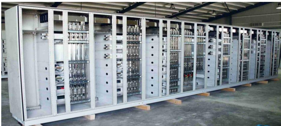
Figura 7. Centro de control de motores.
