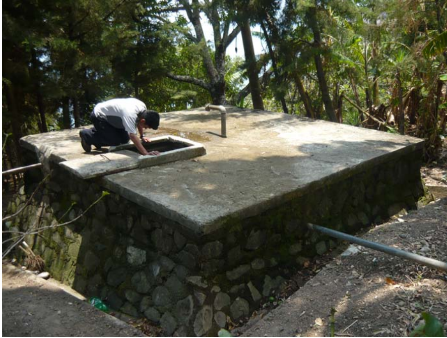
No. 34: Tanque de distribución del sistema de agua potable de Santa Cruz La Laguna
