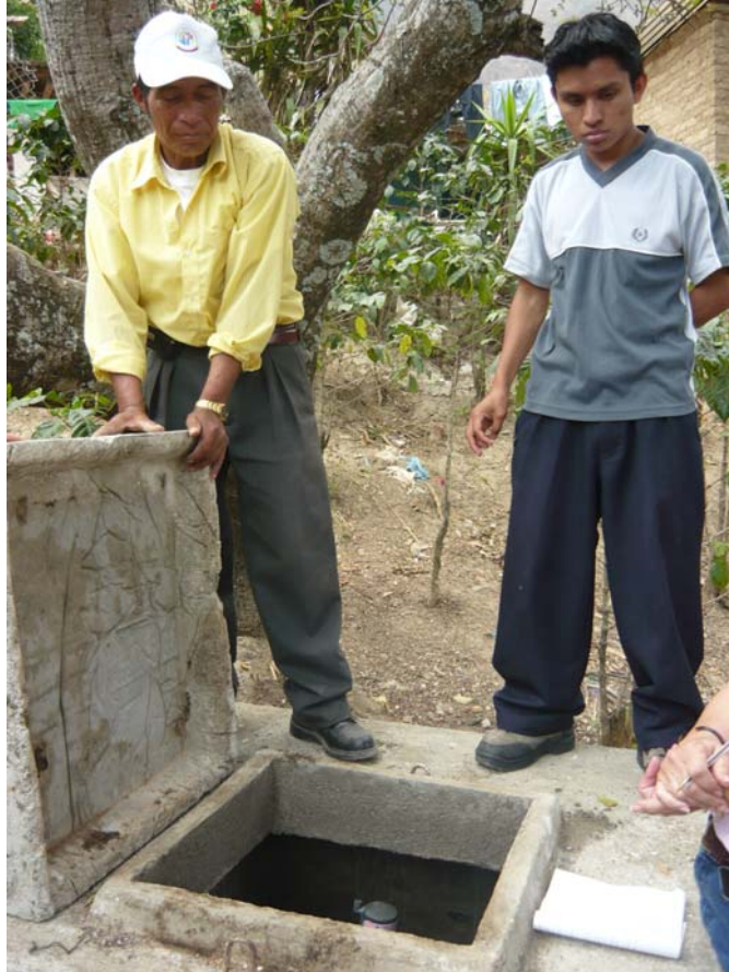
No. 36: Caja Rompe Presión del sistema de distribución de agua potable
