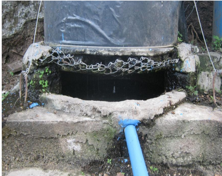
Figura No. 6 Fotografías del sistema recolector del agua tratada
