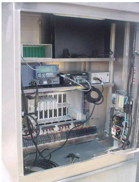
Figura 40. Gabinete y sus partes interconectadas
