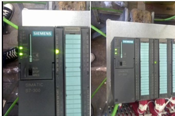
Figura 147. Pruebas de migración activación de entradas y salidas digitales en módulos
