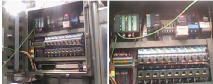
Figura 151. El tablero después de la implementación de migración
