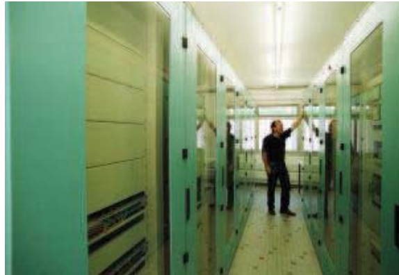
Figura 20. Cubículos de protección y control de bahía
