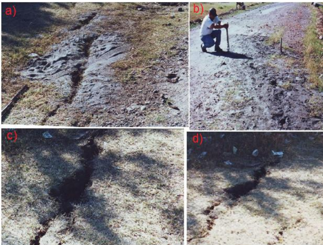
Fotografía 6: Las Lisas, fotos de las grietas debido al terremoto de El Salvador 2001 (Fotos Pablo Palma Ponce)
