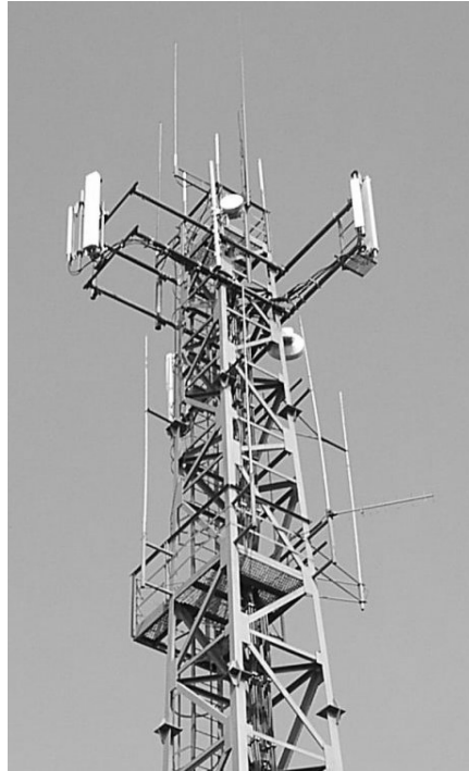
Figura 3. Estación base transceptora.
