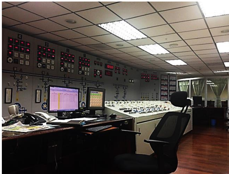
Figura 6. Centro de control de casa de máquinas
