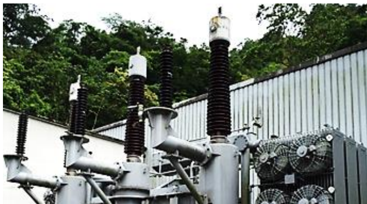
Figura 16. Bushings de los transformadores de la planta Chixoy
