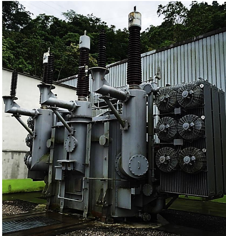
Figura 9. Transformador principal Hidroeléctrica Chixoy
