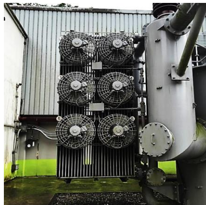
Figura 14. Sistema de enfriamiento de los transformadores de la planta Chixoy
