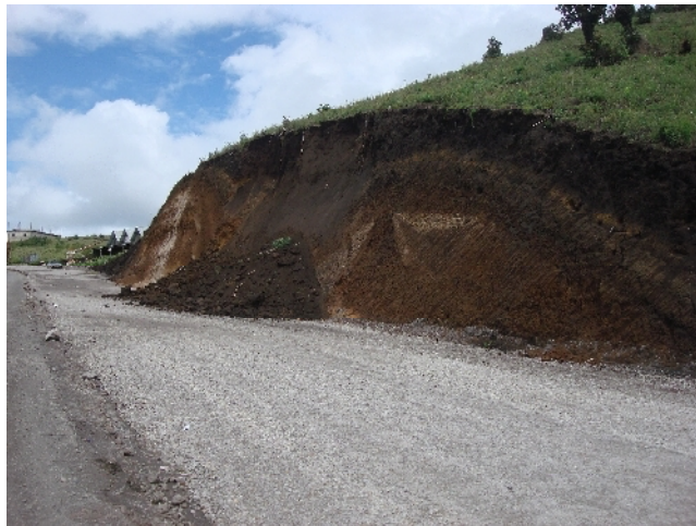
Figura 47. Deslizamiento parte Corona 122 + 710
