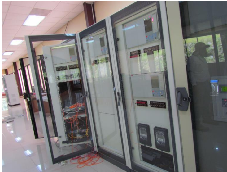
Figura 15. Centro de mando de El Manantial
