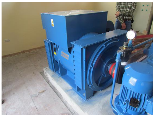
Figura 21. Pequeña hidroeléctrica Concepción
