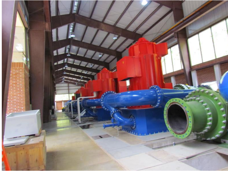
Figura 14. Central hidroeléctrica El Manantial
