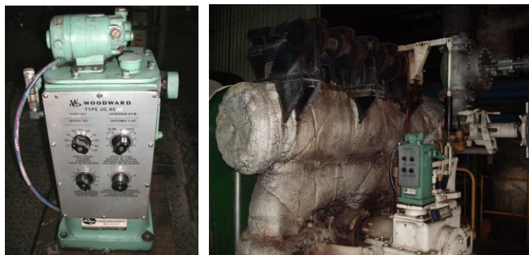
Figura 20. Gobernador Woodward instalado actualmente
