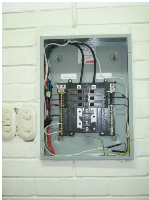
Figura 16. Tablero eléctrico, área de piscina
