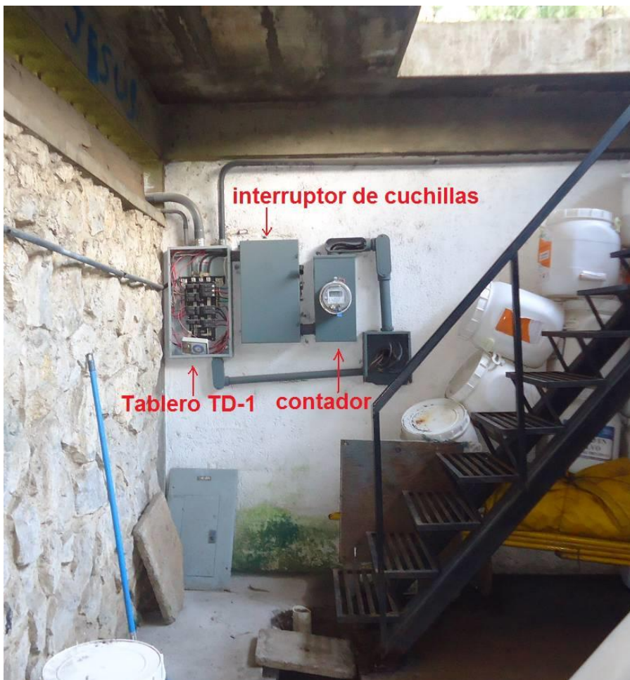
Figura 15. Instalaciones eléctricas, cuarto de bombas
