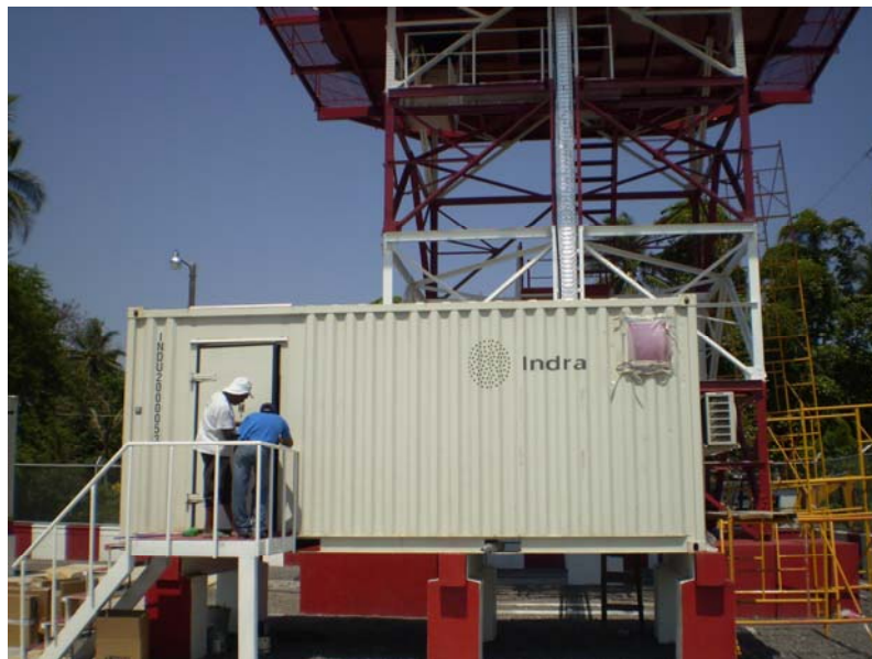
Figura 57. Contenedor para los diferentes equipos radar
