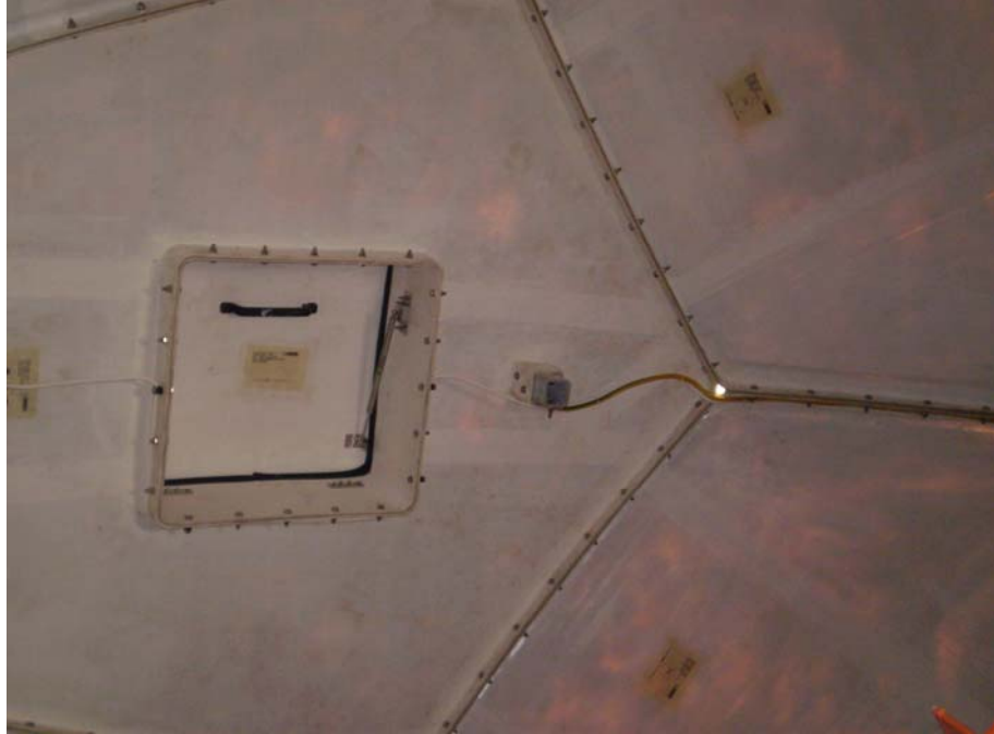
Figura 60. Ventanilla del radomo / cableado de pararrayos
