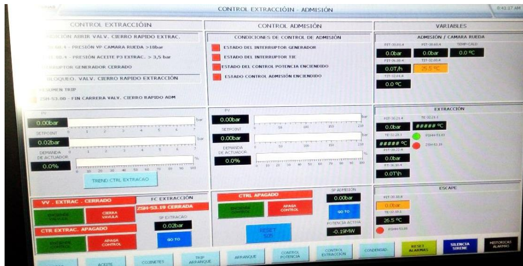
Figura 33. Pantalla de control de extracción y admisión del tubo
