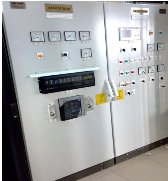
Figura 36. Tablero de control del generador
