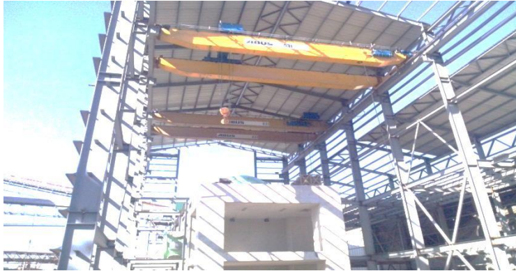
Figura 22. Grúas puente en paralelo
