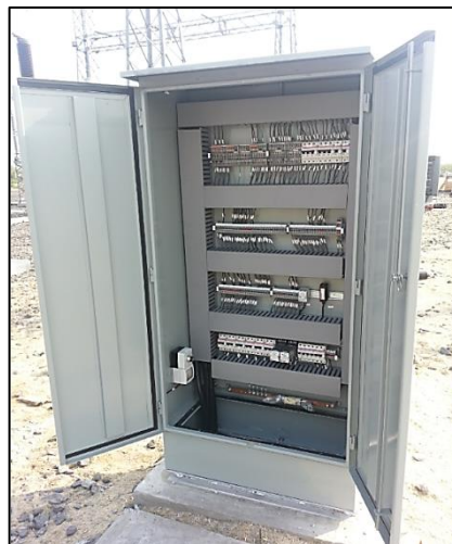
Figura 40. Gabinete concentrador instalado en el Ingenio Santa Ana
