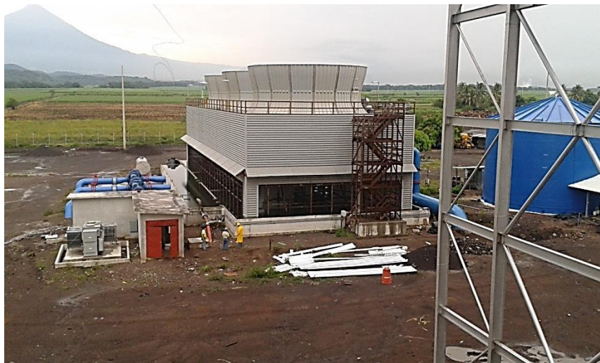
Figura 20. Torre de enfriamiento
