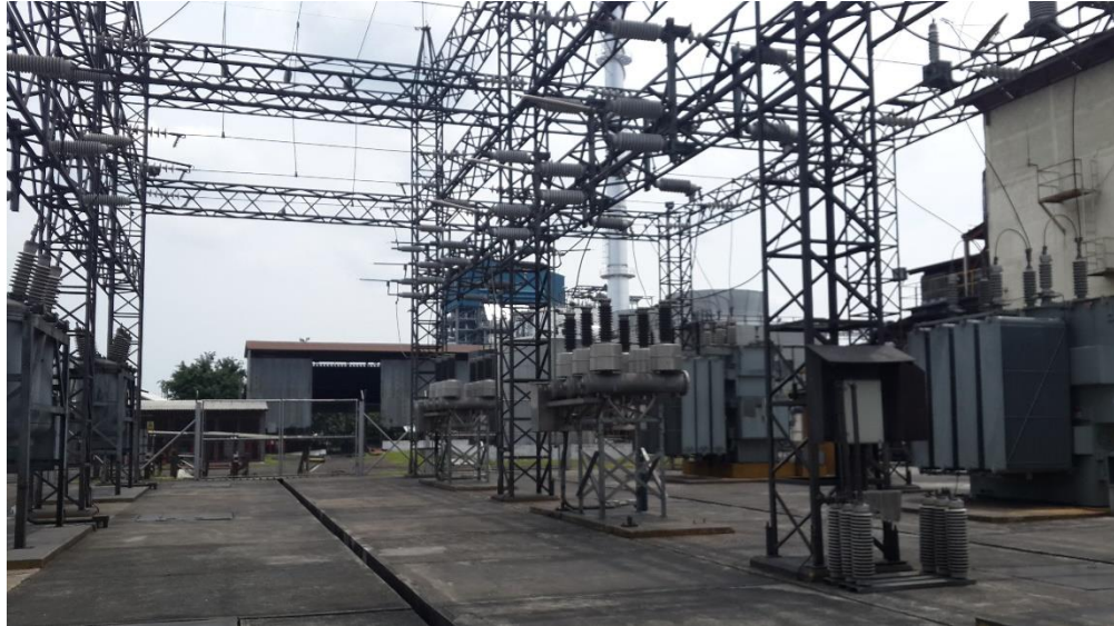
Figura 11. Subestación 69 kV sin modificar
