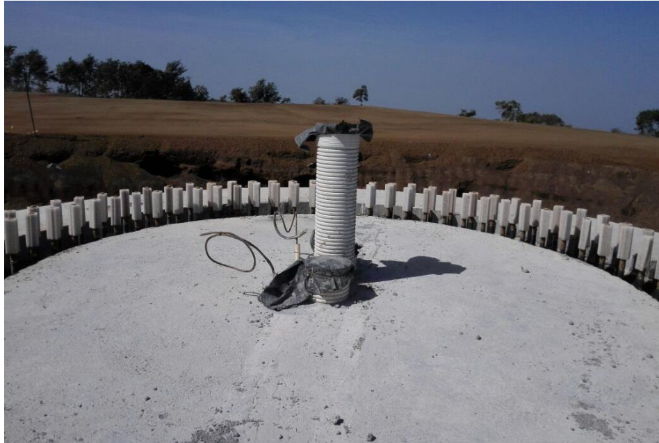
Figura 22. Tubos de conexión al interior de los aerogeneradores
