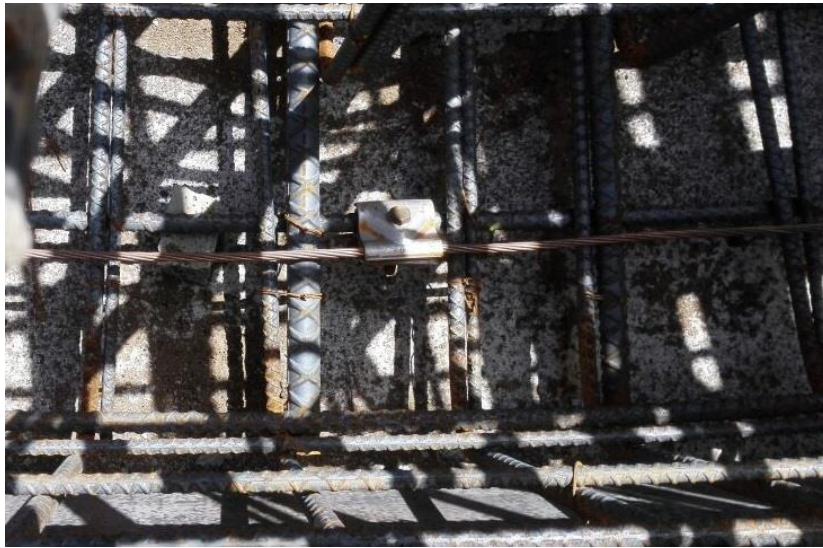
Figura 32. Conexión de cable de tierra a la armadura de la zapata del aerogenerador
