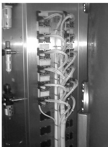
Figura 41. Foto de banco de válvulas neumáticas
