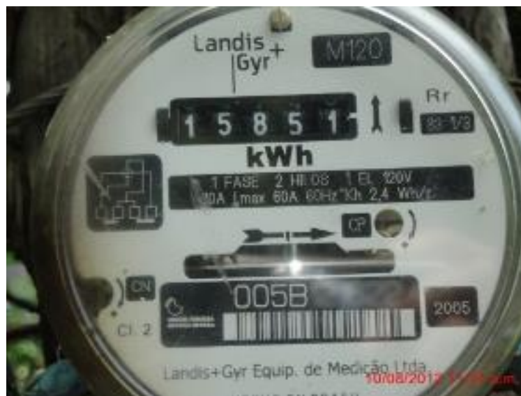
Figura 2. Registro de medidor electromecánico con registro ciclométrico
