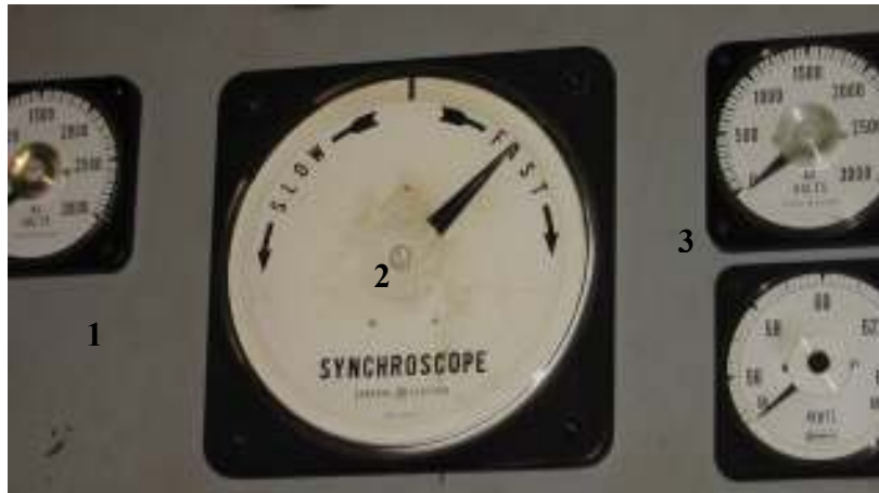
Figura 22. Parte del panel de control del turbogenerador
