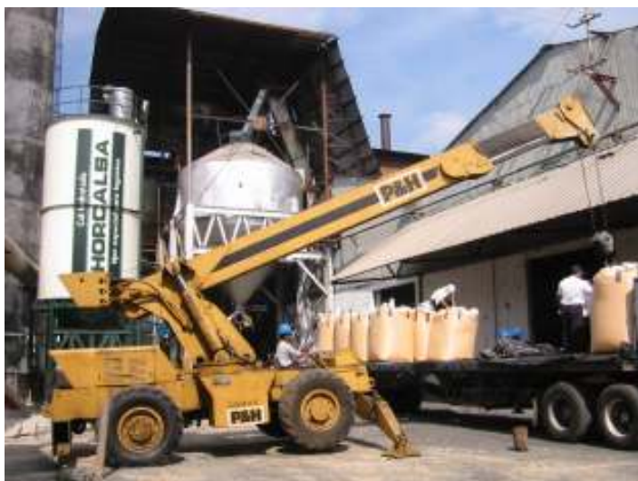
Figura 3. Grúa P&H R150
