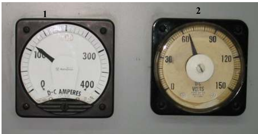
Figura 21. Amperímetro y voltímetro de dispositivo de disparo
