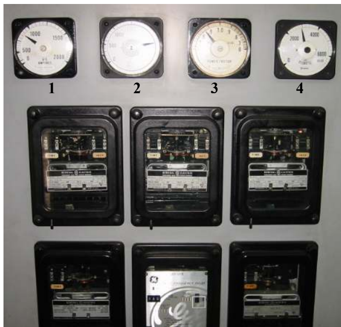
Figura 23. Parte del panel de control del turbogenerador
