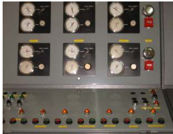
Figura 19. Panel de controles y arrancadores de motores eléctricos de las calderas
