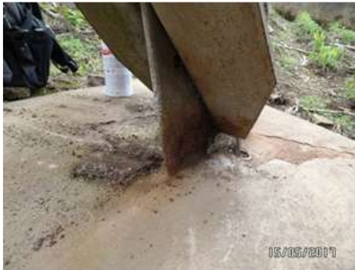
Figura 40. Ejemplo de angulares corroídos
