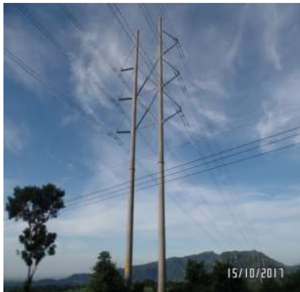
Figura 19. Fotografía de poste de concreto
