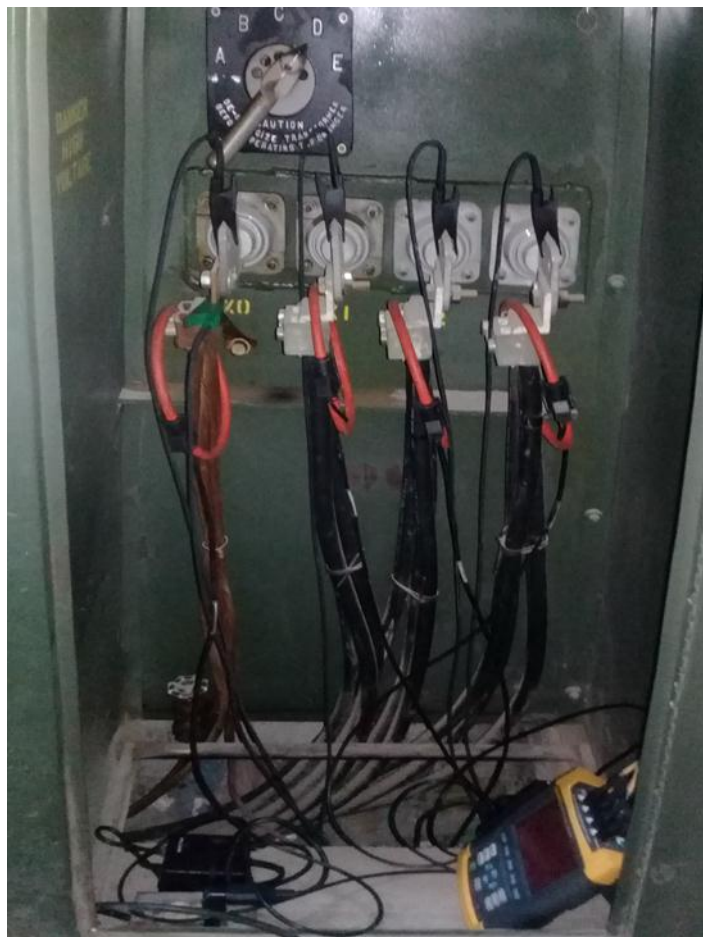
Figura 3. Instalación del Fluke 435 clase A en la Biblioteca Central
