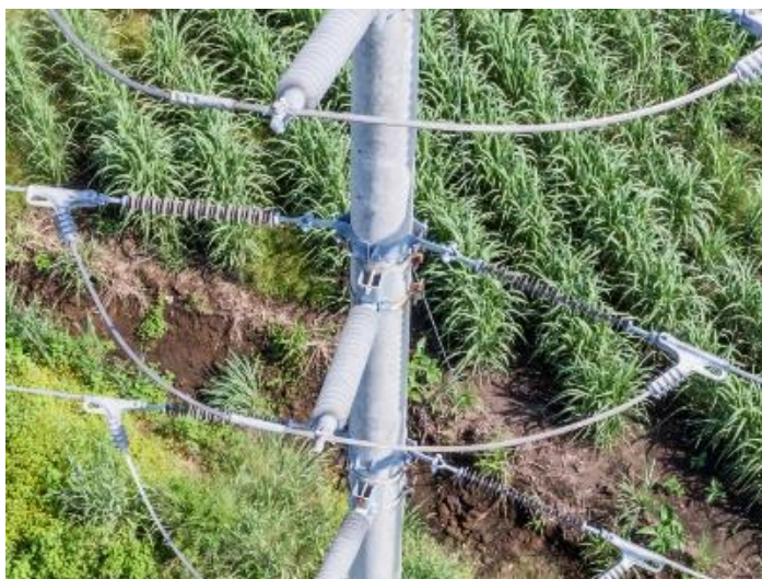
Figura 152. Puente eléctrico en línea de transmisión
