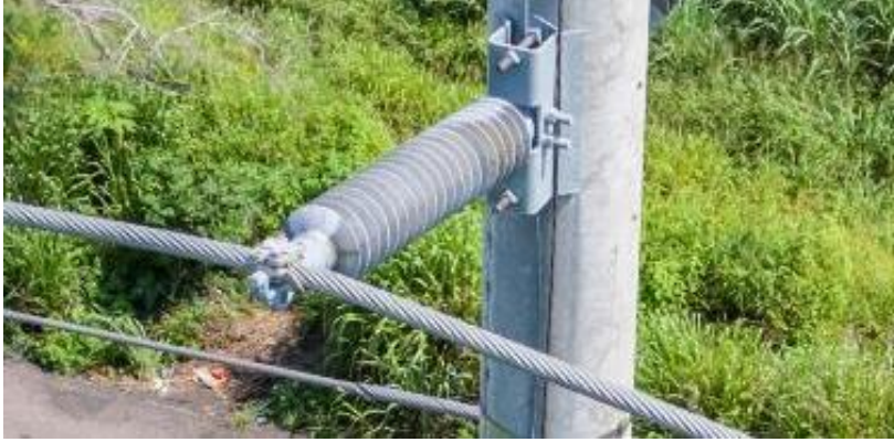
Figura 182. Aislador dañado por descarga atmosférica
