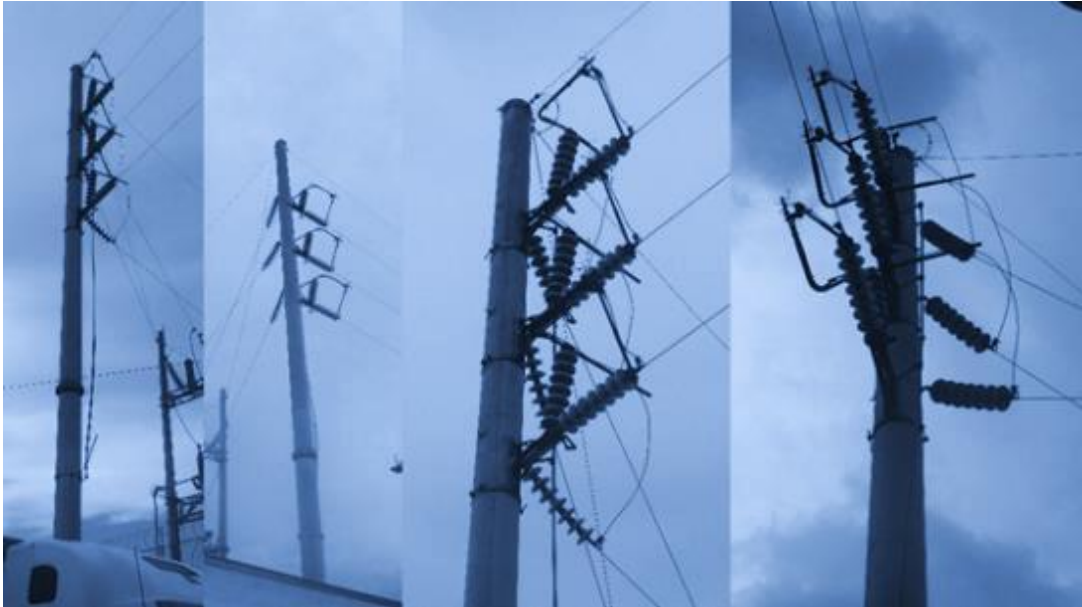
Figura 98. Seccionador de aire trifásico en línea marca KPF en ángulo
