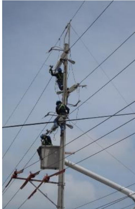
Figura 180. Mantenimiento y calibración de seccionador KPF
