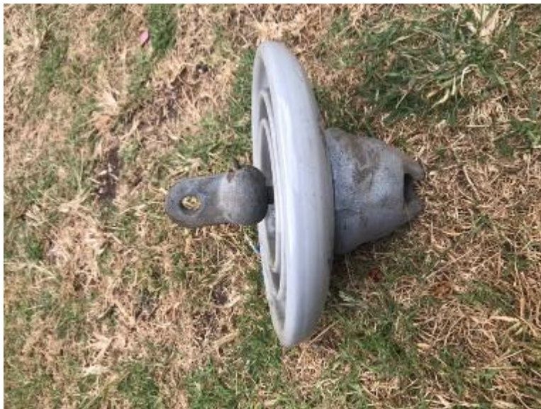
Figura 37. Aislador de porcelana de remate de disco de 10" para monopolos de líneas de transmisión de 69 kV
