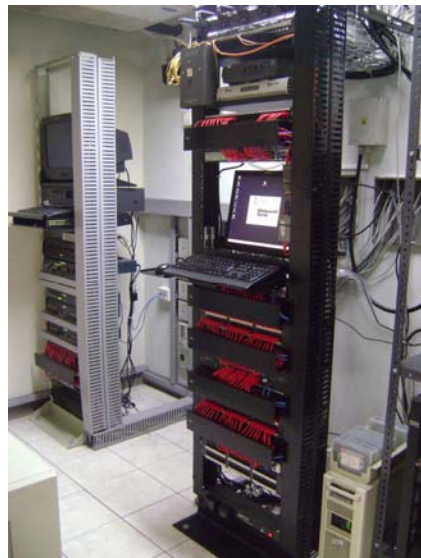
Figura 41 Rack de datos y telefonía
