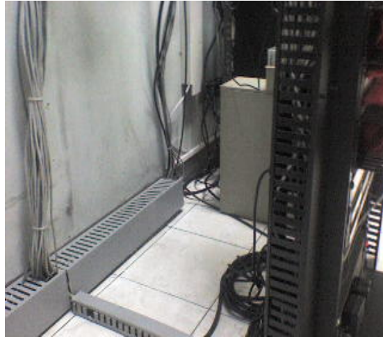
Figura 42 Área sin cableado
