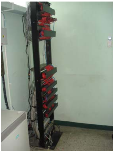
Figura 35 Rack y cableado
