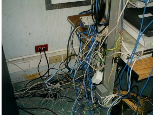
Figura 24 Cableado expuesto cuarto de servidores
