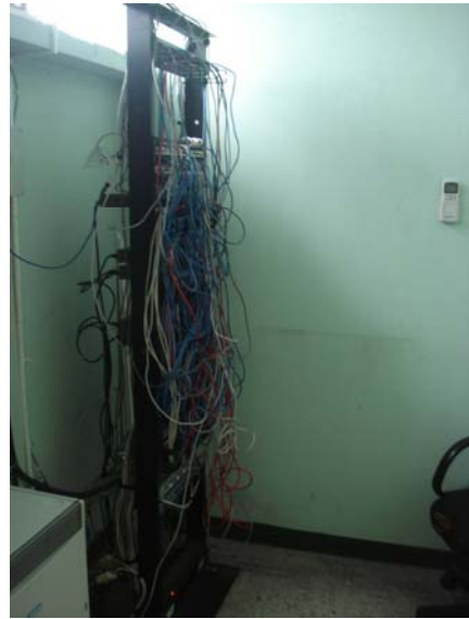
Figura 34 Cableado de datos
