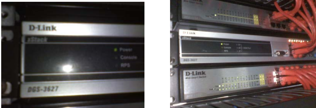
Figura 53 Swich Dlink capa 3 DGS-3627 instalado como switch core
