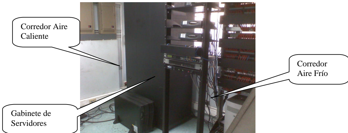
Figura 32 Nueva ubicación de UPS y gabinete
