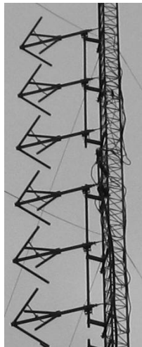
Figura 44. Sistema radiante de 6 antenas instalado
