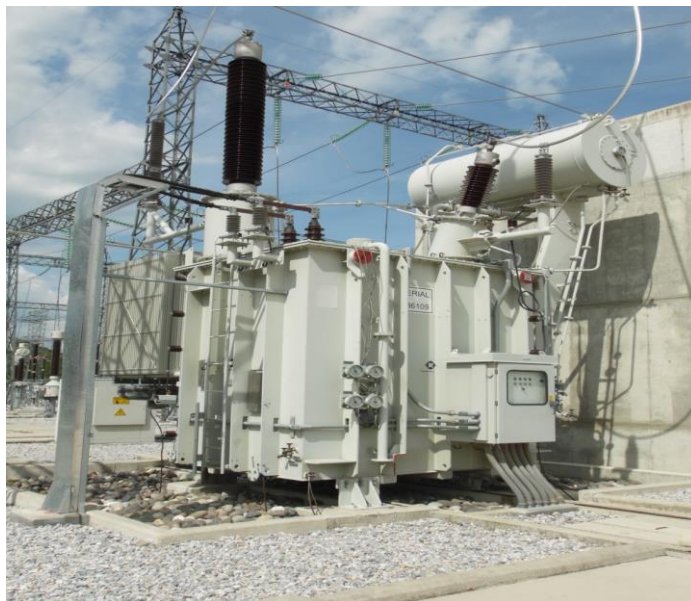
Figura 1. Transformador de potencia
