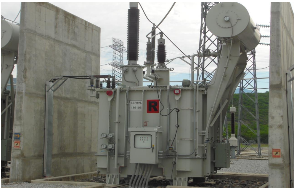
Figura 2. Transformador de subestación
