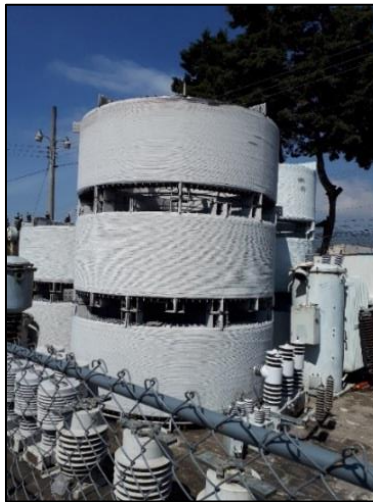
Figura 16. Reactor limitador de corriente
