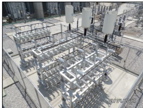
Figura 17. Banco de capacitores
