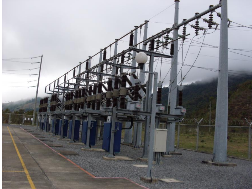
Figura 37. Módulos de 69 kV
