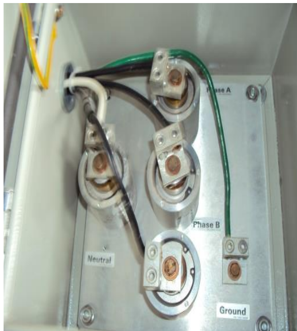
Figura 5. Supresor de transitorios instalado en el hospital
