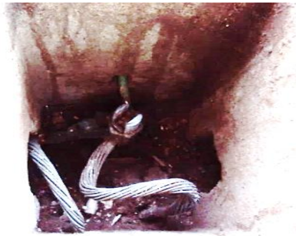
Figura 45. Varilla de polo de tierra de aterrizado de equipos
