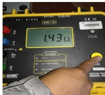
Figura 48. Medición de resistencia del polo de aterrizado del cable neutral
