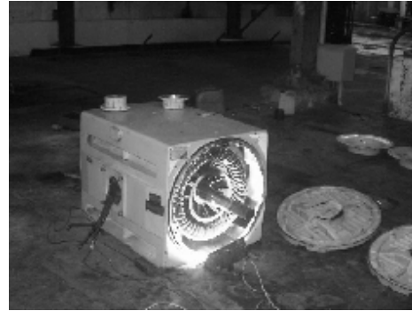
Figura 16. Motor eléctrico sellado
