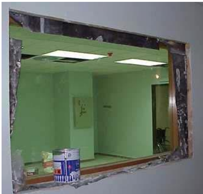
Figura 52. Blindaje con plomo para sala de rayos X
