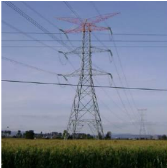
Figura 59. Torre de transmisión de flujo eléctrico
