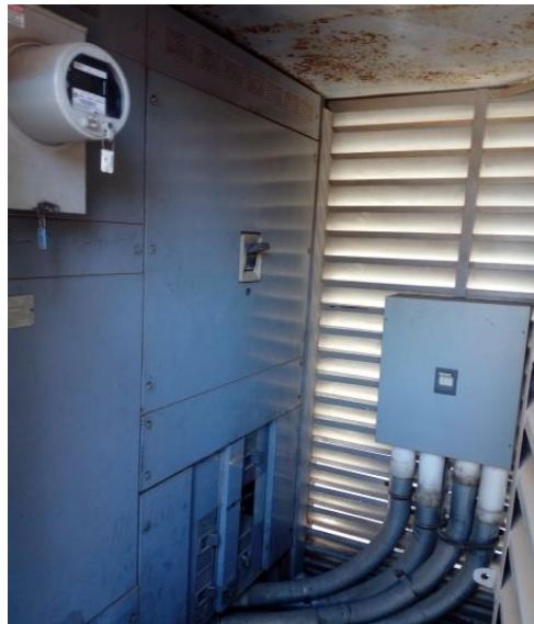
Figura 6. Tablero y medidor principal
