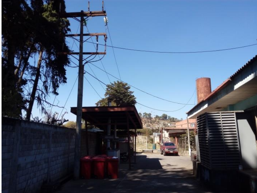
Figura 5. Vista del ingreso trifásico principal
