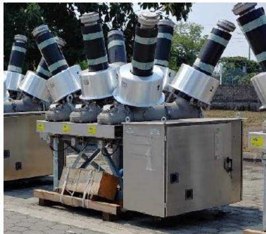
Figura 6. Interruptor de tanque muerto
