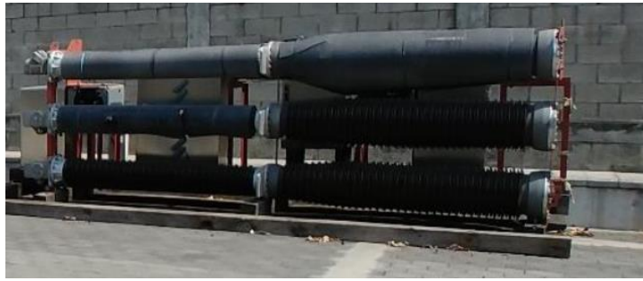
Figura 5. Interruptor de tanque vivo
