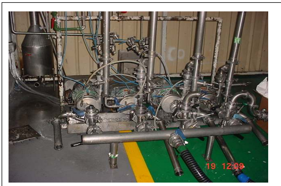
Figura 12. Foto de mangueras de conexión
