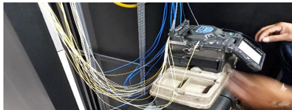
Figura 124. Fusiones de fibra óptica
