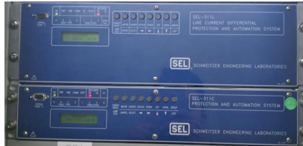
Figura 24. Relés de protección microprocesados
