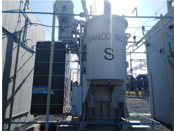
Figura 6. Transformador de potencia monofásico
