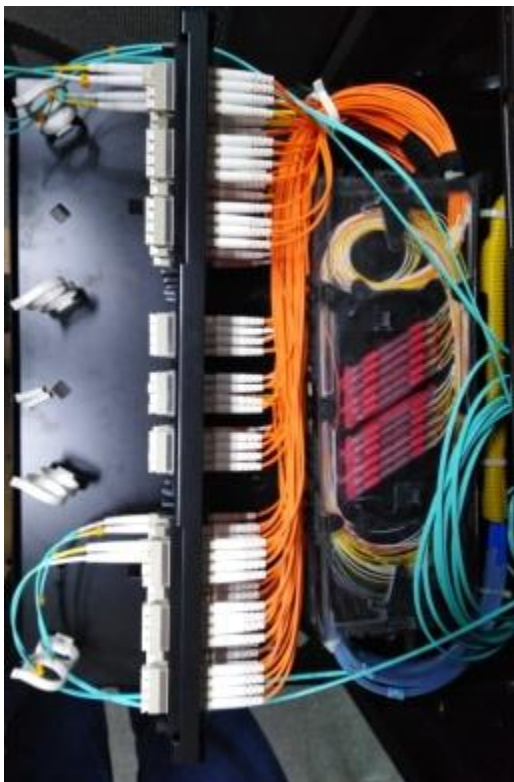
Figura 119. Distribuidor de fibra óptica en sala de relés
