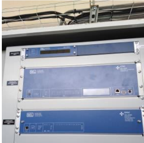
Figura 117. Controladores de automatización
