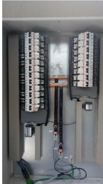
Figura 109. Tablero de distribución de corriente directa
