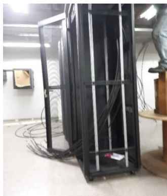
Figura 123. Cableado de fibra óptica en gabinete de comunicaciones
