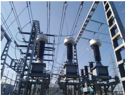
Figura 9. Transformadores de tensión
