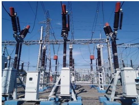
Figura 4. Interruptores de potencia
