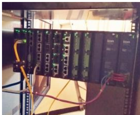
Figura 92. Multiplexor de fibra óptica
