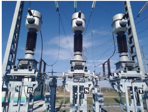
Figura 11. Transformadores de medida combinados
