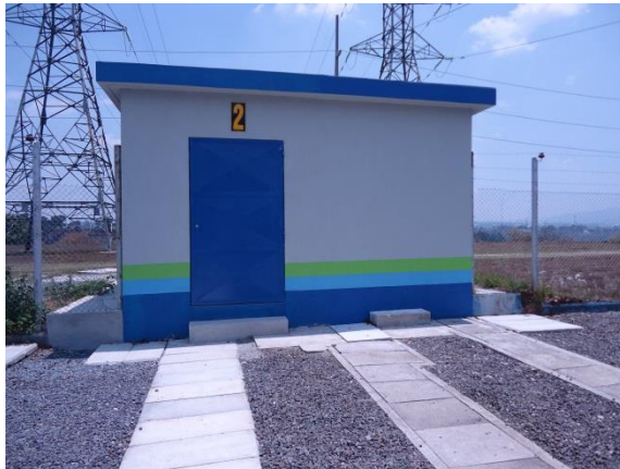
Figura 99. Caseta Subestación Guatemala Sur
