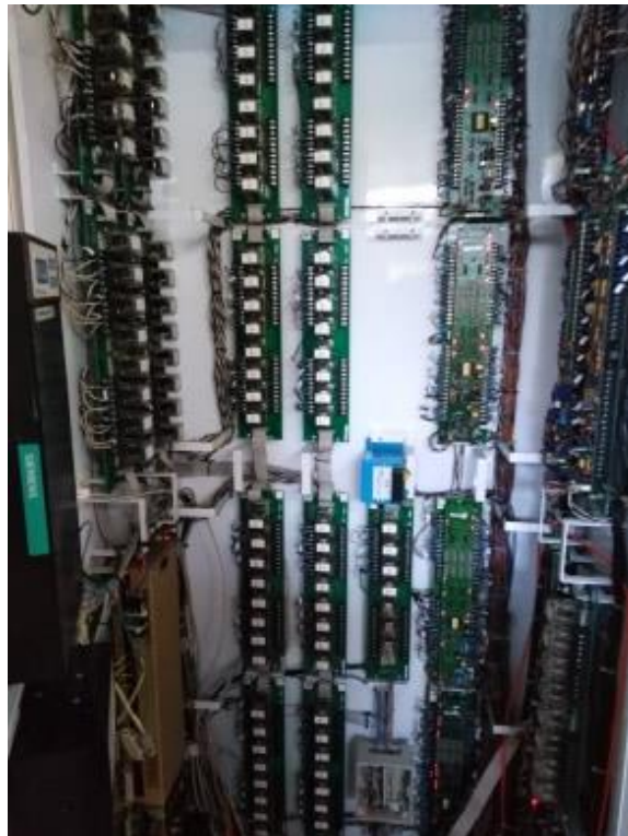
Figura 96. Unidad Terminal Remota RTU
