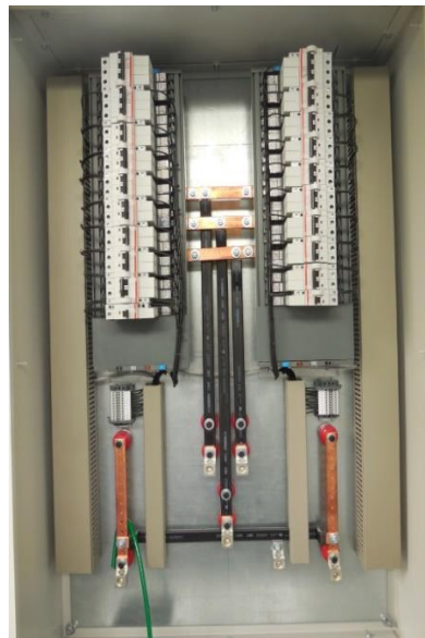
Figura 108. Tablero de distribución de corriente alterna
