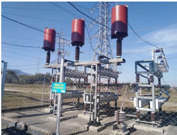
Figura 15. Banco de capacitores
