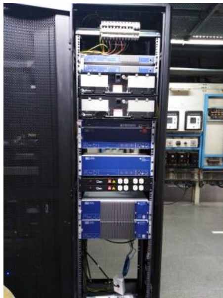
Figura 125. Gabinete de comunicaciones
