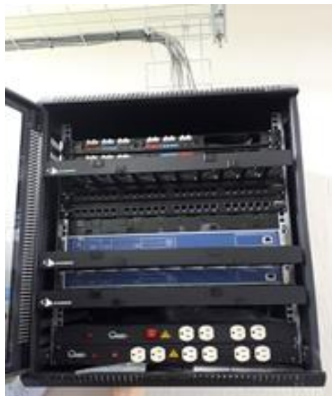
Figura 118. Rack de comunicaciones
