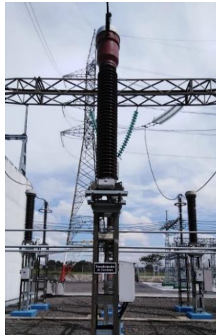
Figura 8. Transformador de corriente
