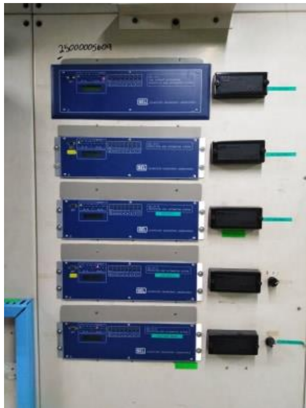
Figura 95. Relés de protección en bahías de 69 kV
