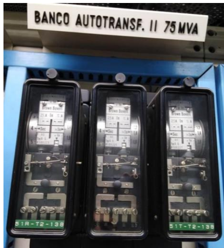
Figura 23. Relés de sobrecorriente electromecánicos
