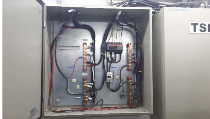
Figura 110. Tablero principal de corriente alterna
