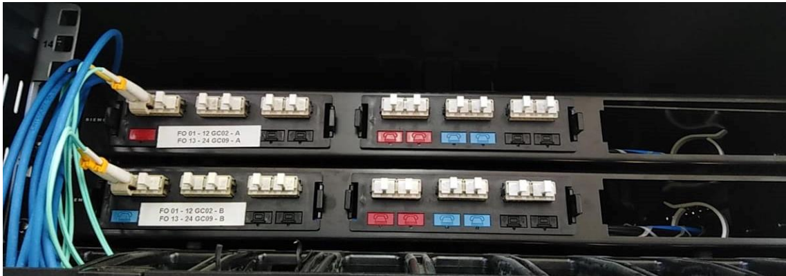
Figura 120. Distribuidores de fibra óptica caseta 2
