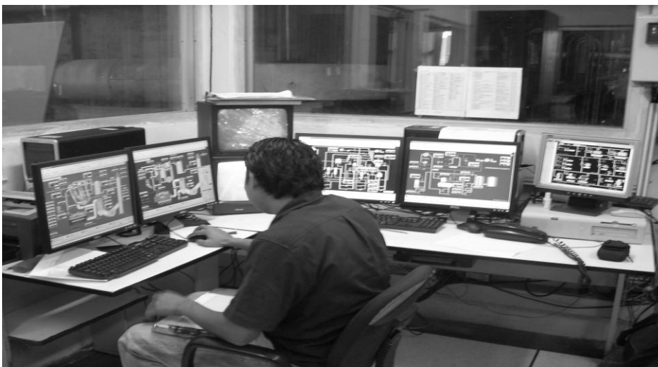
Figura 61. Estaciones de trabajo instaladas en el cuarto de control
