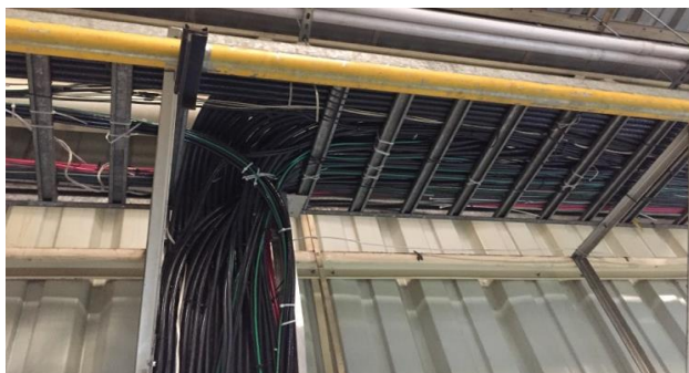
Figura 7. Bandeja porta cables tipo escalera
