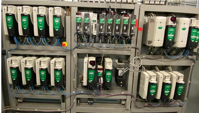
Figura 26. Centro de control de motores
