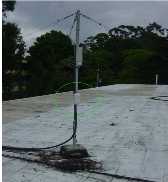
Figura 15. Equipo inalámbrico instalado en edificio M-6
