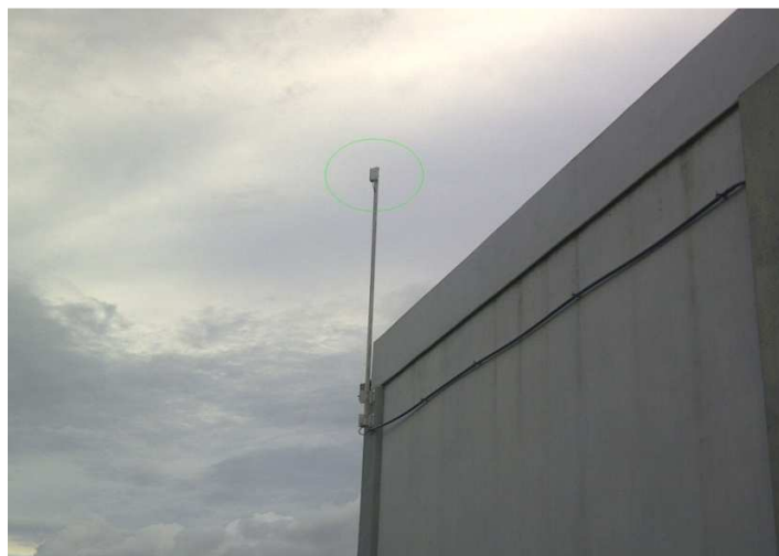
Figura 16. Equipo inalámbrico instalado en edificio ERIS
