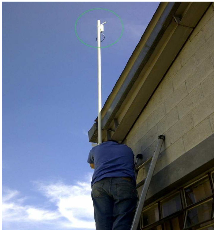
Figura 17. Equipo inalámbrico instalado en edificio EPS
