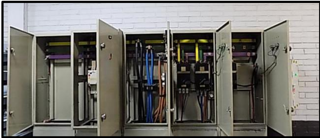
Figura 20. Tablero de distribución normal TDN 1 (16)
