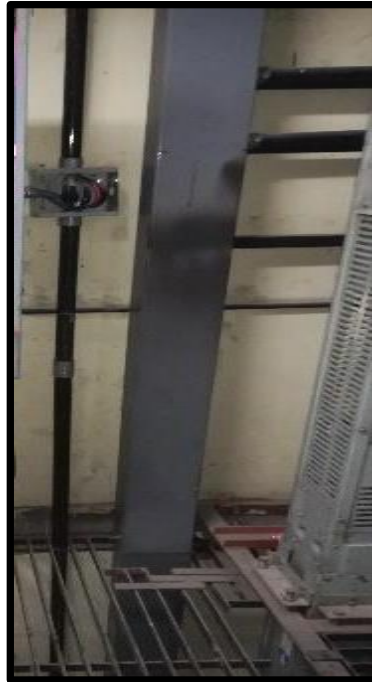
Figura 26. Canaleta metálica en ducto vertical de torre
