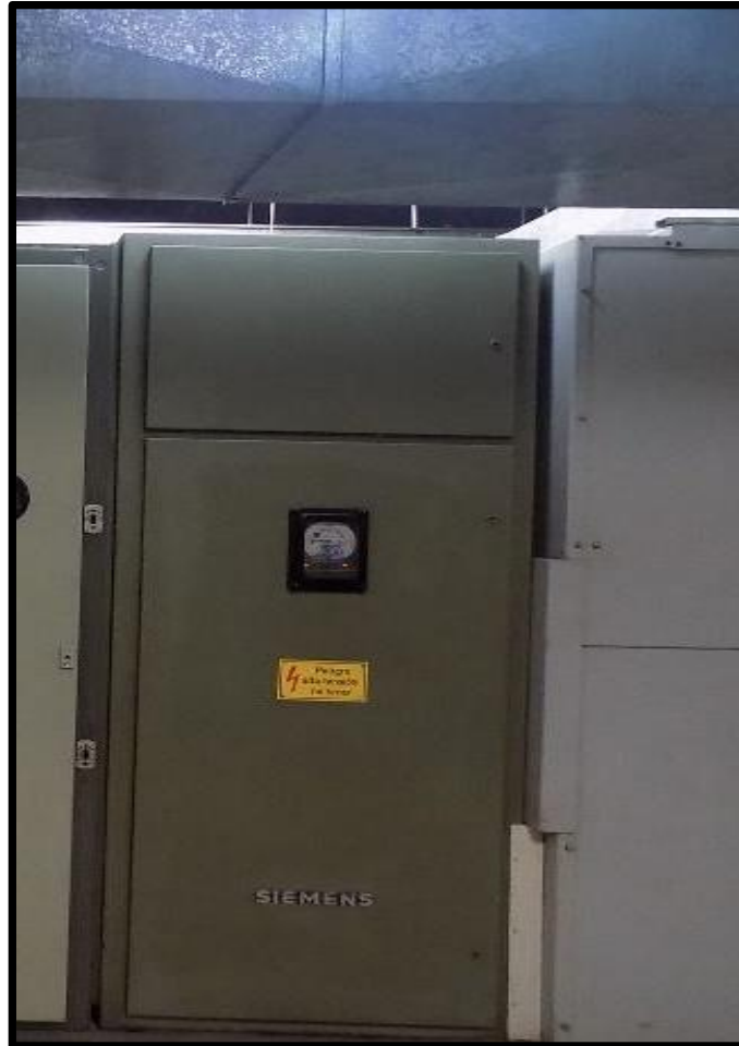
Figura 15. Medidor de energía en subestación
