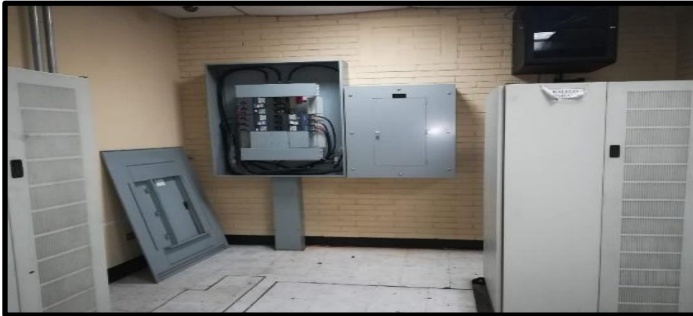
Figura 22. Unidades del sistema de alimentación ininterrumpida y tablero de derivación (bypass) interno
