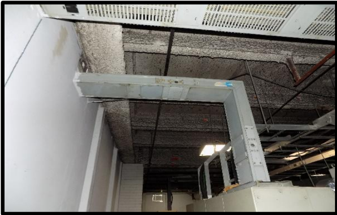
Figura 25. Ducto barra en subestación
