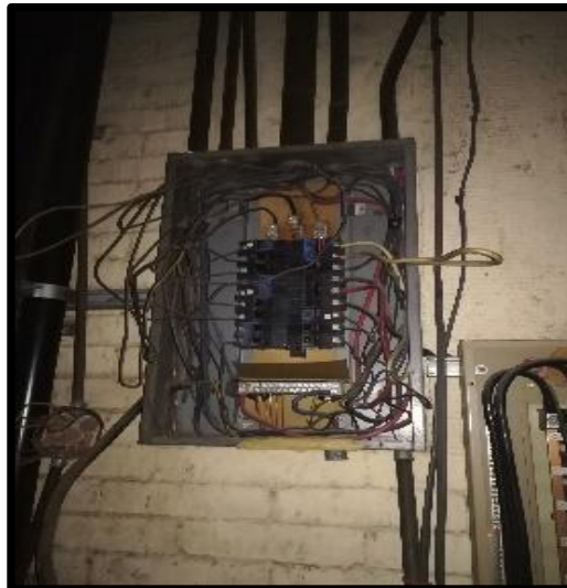
Figura 32. Tableros ubicados en sótanos
