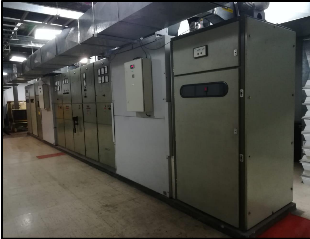
Figura 13. Subestación unitaria 2 MW (1-2-3-4-5-6-7-8-9-10-11)
