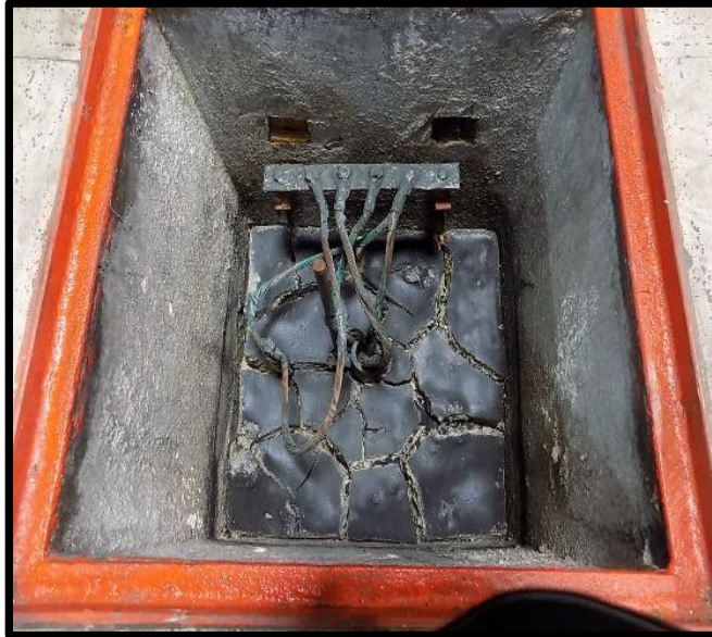
Figura 27. Caja de registro del sistema de puesta a tierra en subestación
