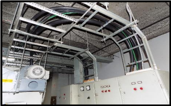
Figura 24. Bandeja porta cable en subestación
