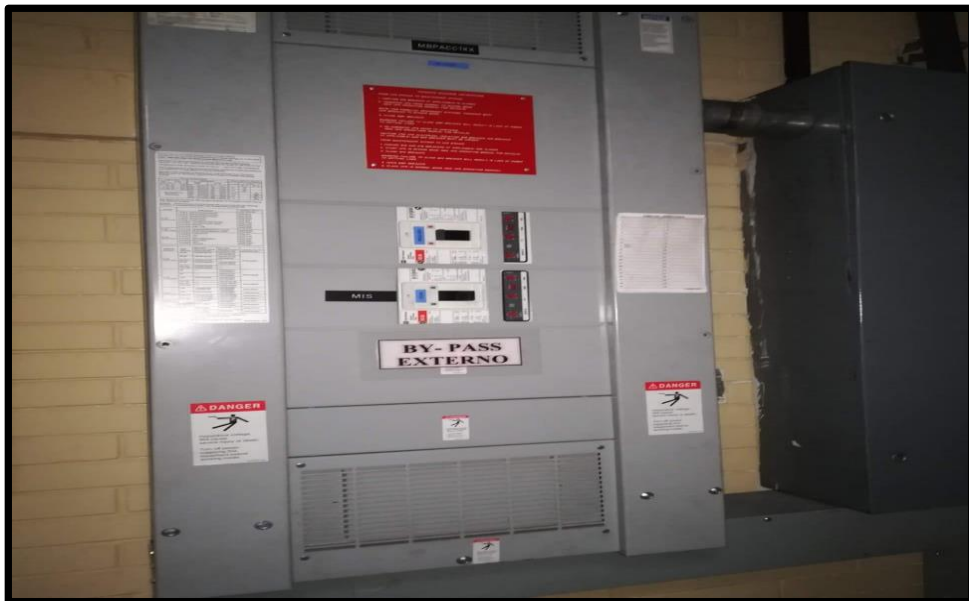
Figura 23. Tablero de derivación (bypass) externo
