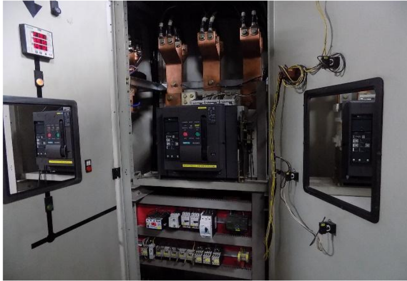
Figura 18. Interruptor tipo ACB ( Air Circuit Breaker ) en tablero de distribución TDE 1
