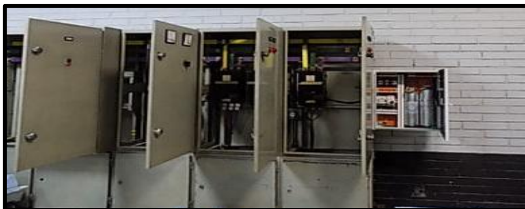
Figura 21. Tablero TDN 1 (16) (ver banco de capacitores)
