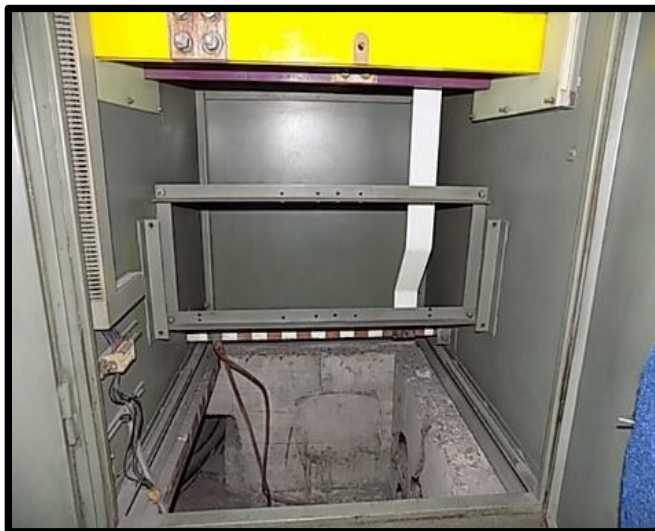
Figura 28. Conexión entre barra de neutro y barra de tierra en subestación
