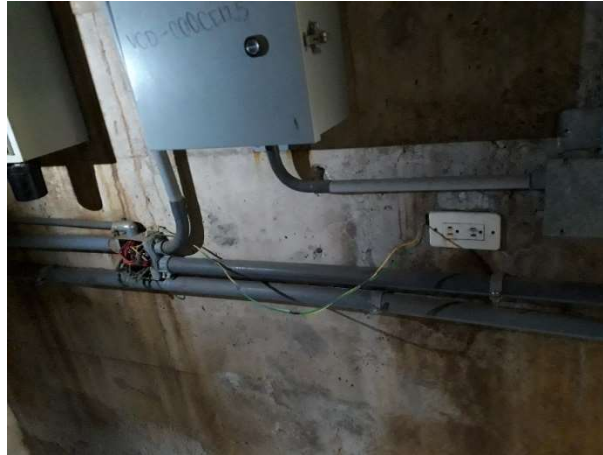
Figura 54. Instalaciones de fuerza en cuarto eléctrico de bombas
