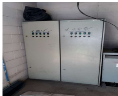
Figura 57. Gabinetes en cuarto de iluminación 1
