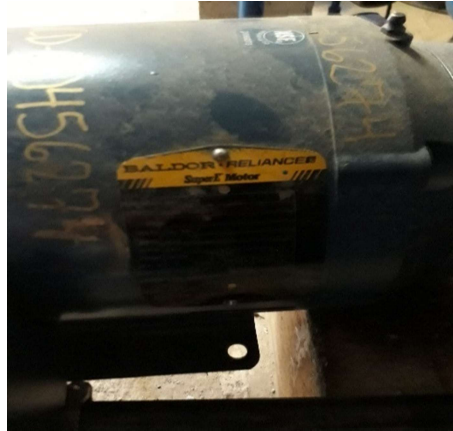
Figura 56. Estado físico de bombas
