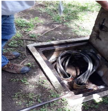
Figura 106. Estado interno para caja de registro área cuarto eléctrico principal
