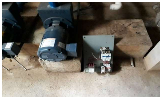
Figura 51. Cuarto de bombas
