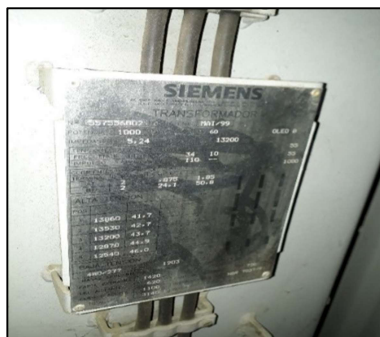
Figura 44. Placa del transformador tipo subestación marca SIEMENS
