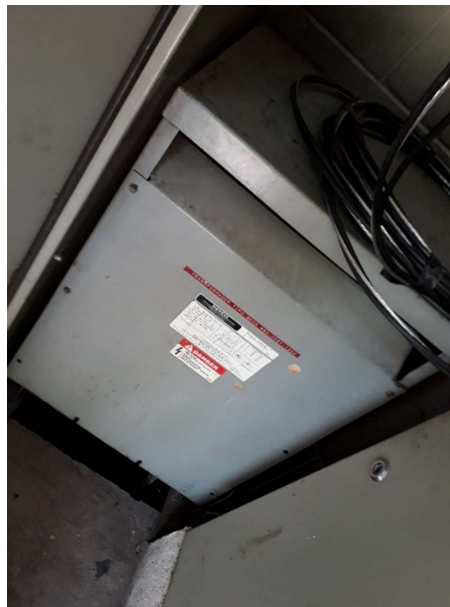
Figura 98. Transformador seco SIEMENS 45KVA
