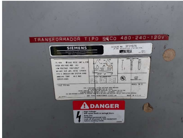
Figura 101. Transformador seco SIEMENS 75KVA
