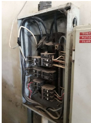
Figura 47. Centro de carga cuarto eléctrico principal
