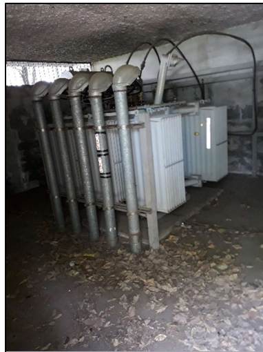
Figura 39. Cuarto eléctrico de potencia
