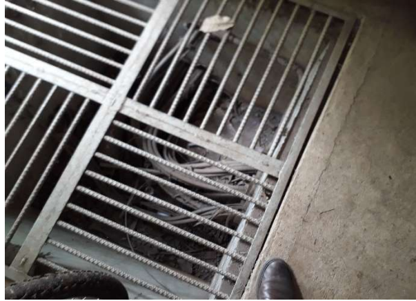
Figura 46. Canalización en cuarto de distribución principal
