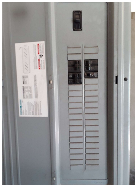
Figura 49. Centro de carga 2
