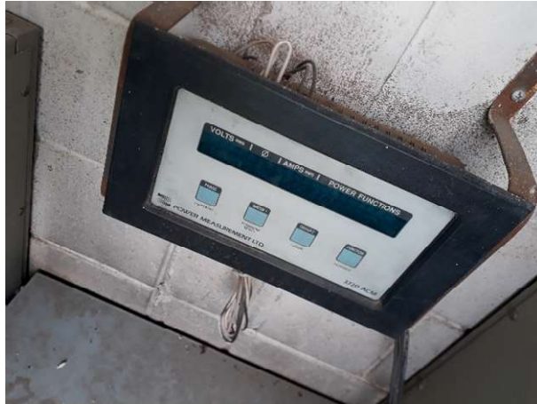
Figura 64. Módulo analógico de voltaje y potencia
