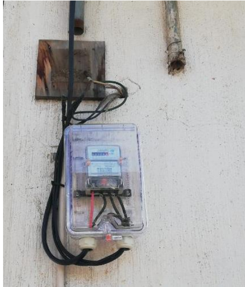
Figura 32. Uso de caja protectora antihurto para medidor de energía
