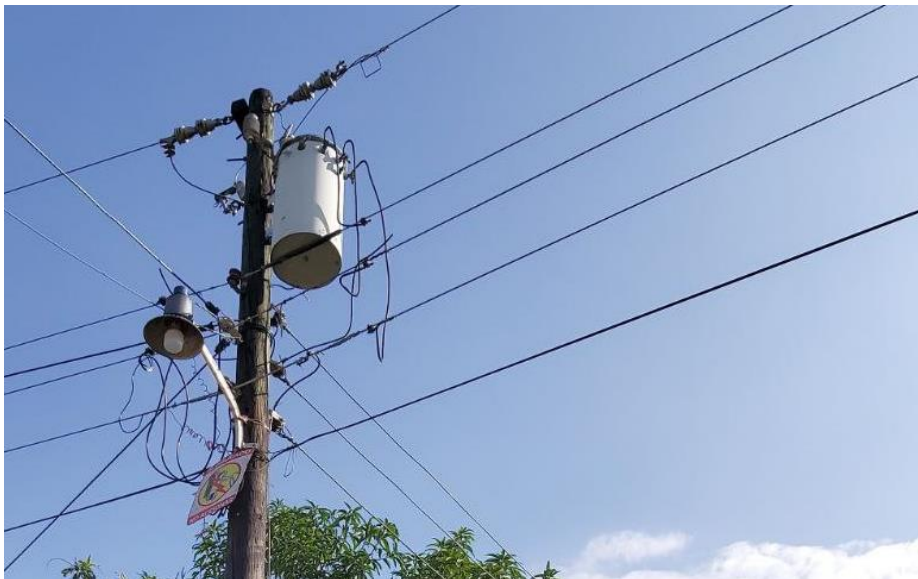
Figura 21. Conductores en red de distribución de línea abierta
