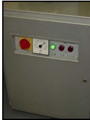
Figura 52. Unidad de refrigeración.
