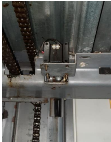
Figura 19. Solenoide de bloqueos mecánicos
