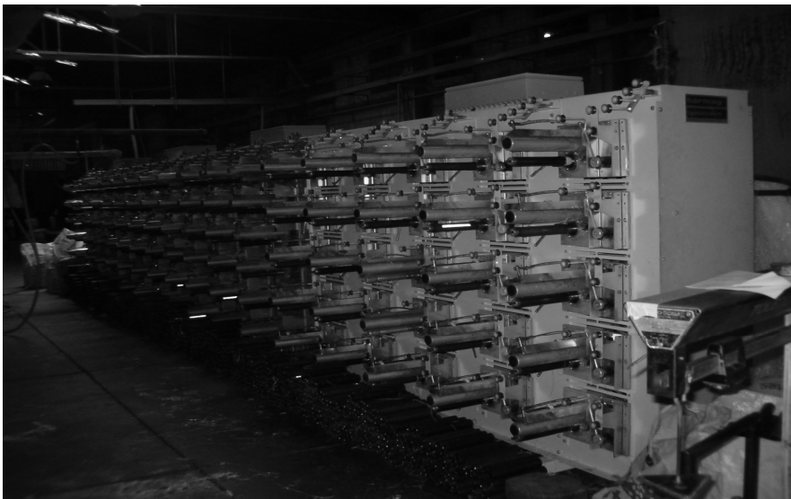
Figura 3. Bobinas de extrusores Polysack
