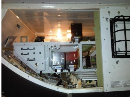
Figura 6. Rack compartimiento trasero
