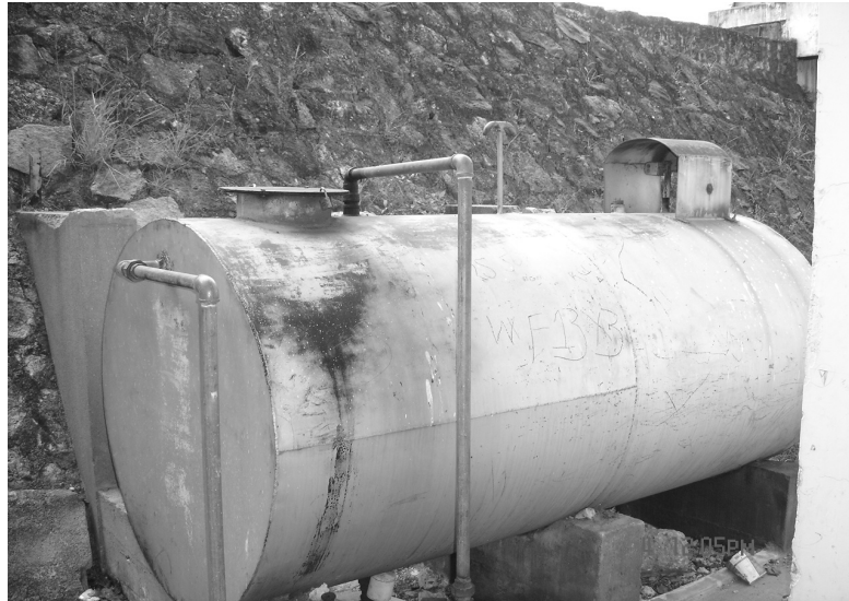
Figura12. Tanque de combustible principal
