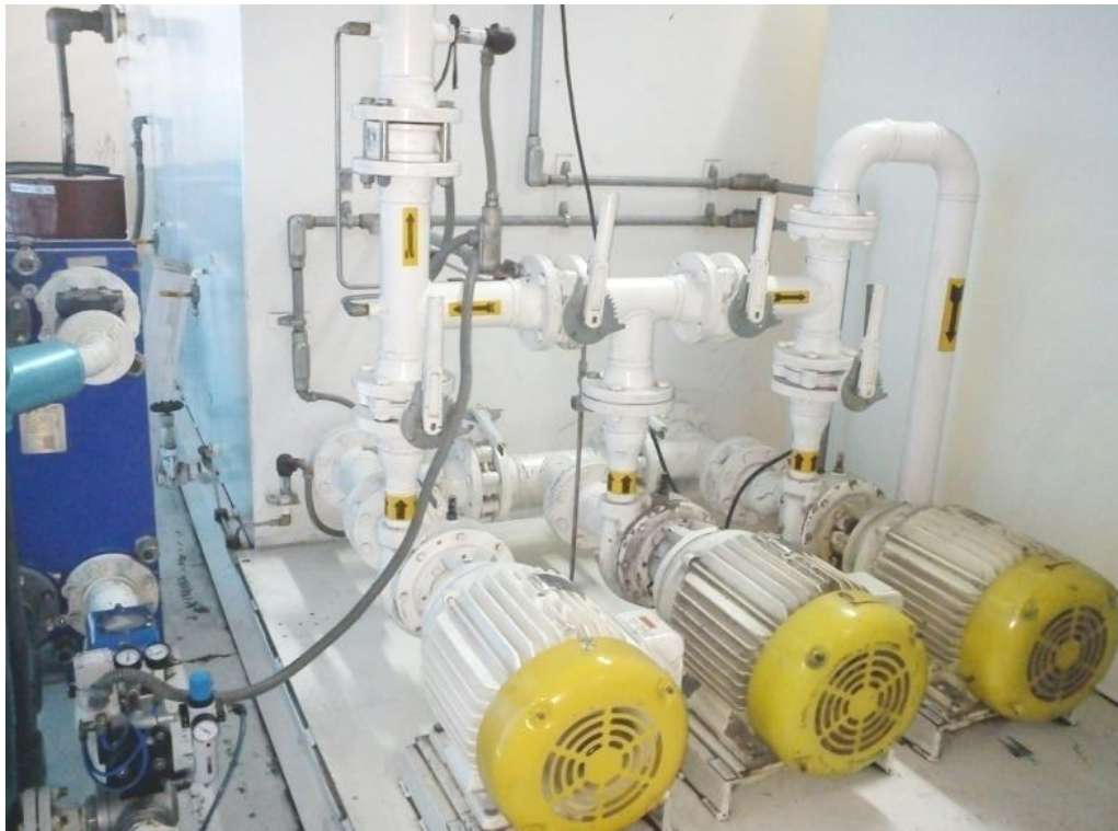
Figura 119. Bombas que envía el soluble a las máquinas después de pasar por el intercambiador de calor
