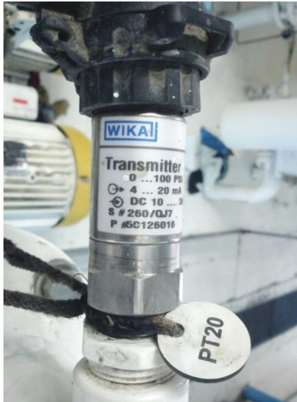
Figura 116. Transmisor de presión, para censar la señal de presión del soluble
