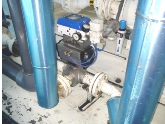
Figura 117. Servoválvula modulando el flujo de agua helada
