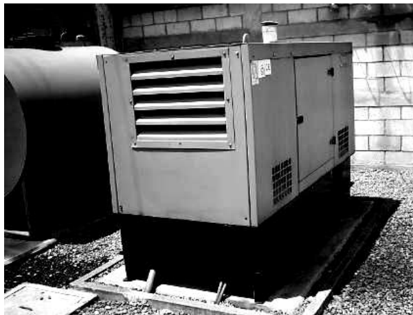
Figura 5. Tanque de diesel y generador eléctrico
