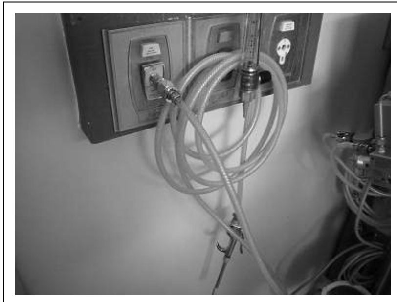
Figura 17. Uso inadecuado del aire comprimido
