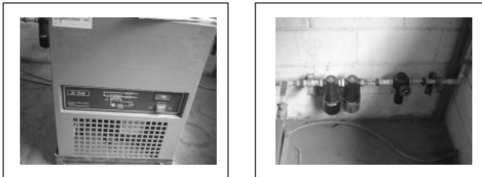
Figura 38. Filtros y deshumidificador
