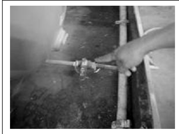
Figura 20. Válvula de purga del tanque
