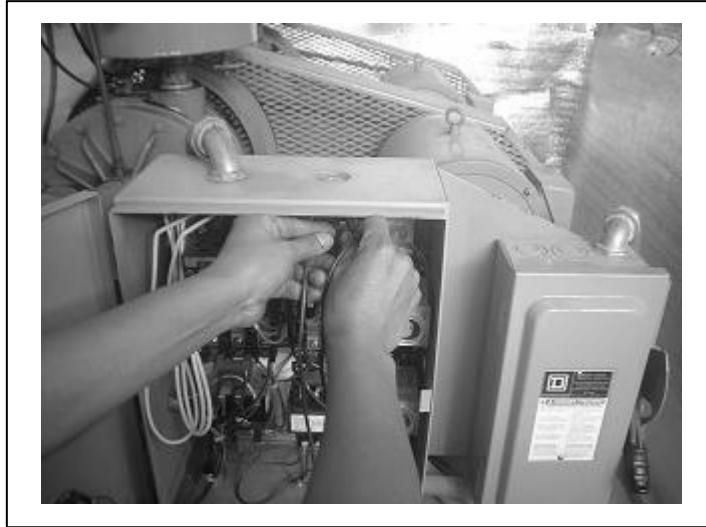
Figura 24. Medición del voltaje de línea
