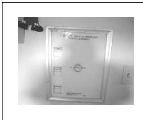
Figura 6 Válvula de seccionamiento
