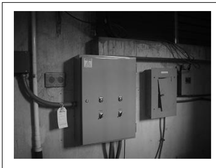
Figura 23. Tablero de control del equipo
