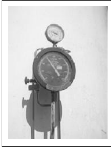
Figura 19. Indicadores de nivel y presión del tanque de oxígeno
