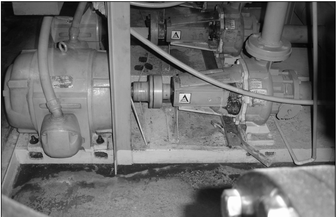
Figura 11. Equipo de bombeo del Hospital General San Juan de Dios
